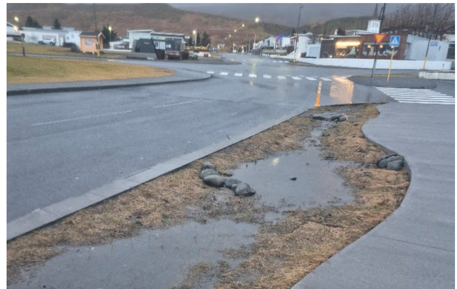
Mynd 3.3 Blágrænar ofanvatnslausnir meðfram Hrannarstíg þar sem eftir á að gróðursetja í regnbeð.
